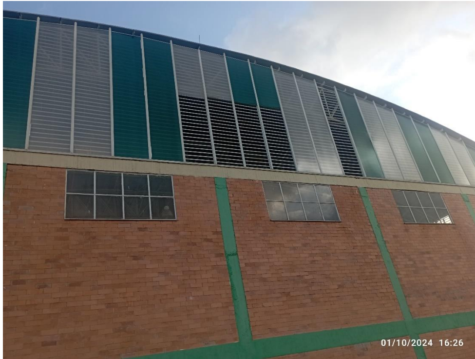
Foto 1: Muro culata del costado occidental, se observa pérdida de unidades de lámina en policarbonato por acción del viento.
