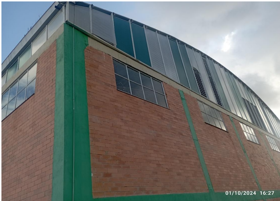
Foto 2: Muro culata del costado occidental, se observa pérdida de unidades de lámina en policarbonato por acción del viento. Se observa crecimiento de vegetación en la canal de aguas lluvias.
