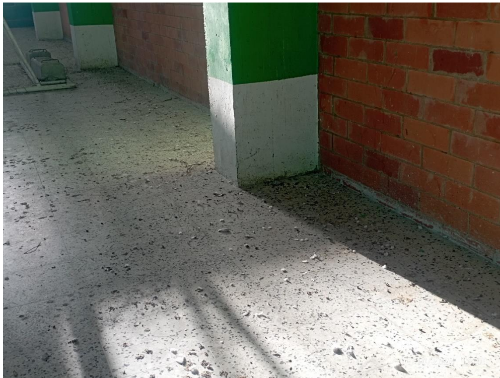
Foto 8: Acumulación de material fecal de las aves en el área interna del polideportivo. Cancha polideportiva
