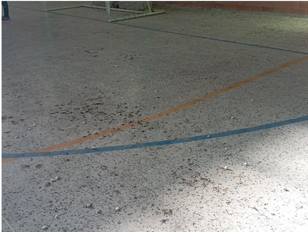
Foto 7: Acumulación de material fecal de las aves en el área interna del polideportivo. Cancha polideportiva
