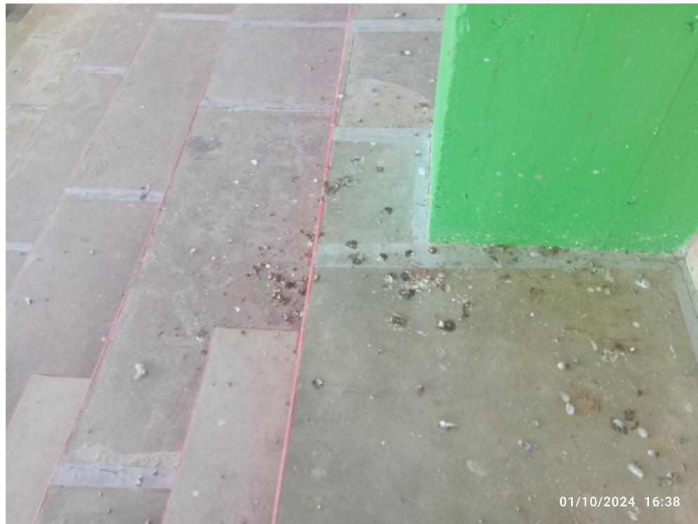
Foto 5: Acumulacion de material fecal de las aves en el área interna del polideportivo
