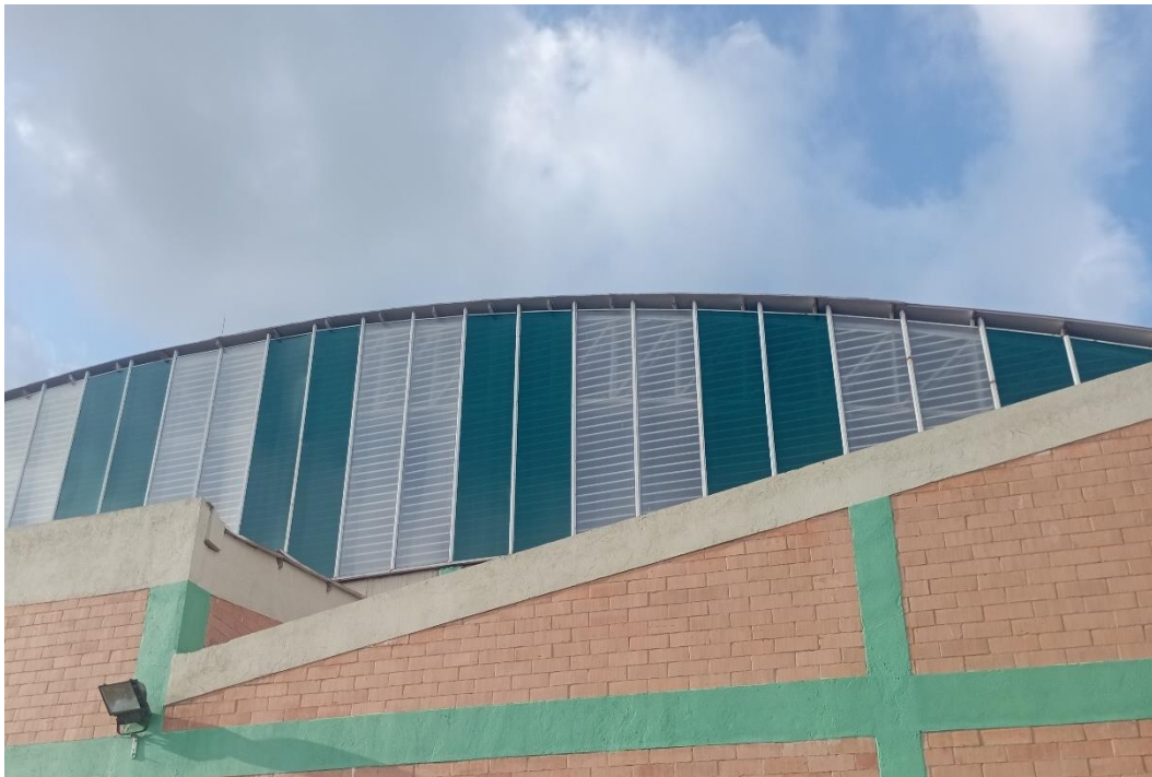
Foto 4: Muro culata del costado oriental, área de tarima y baños. se observa la existencia de espacio entre el policarbonato y las tejas, permitiendo la entrada de las aves.
