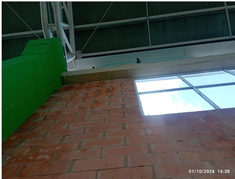
Foto 6: Presencia de varias palomas en las vigas y canales.
