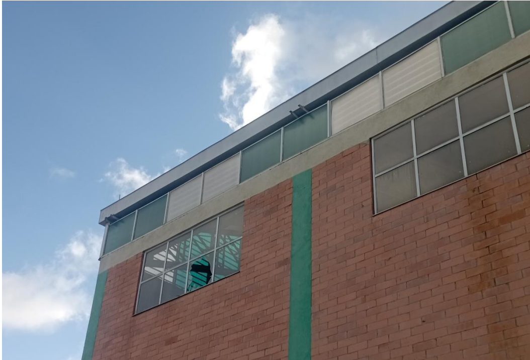
Foto 3: Muro norte, fachada principal, canal con crecimiento de vegetación, vidrios rotos en ventana
