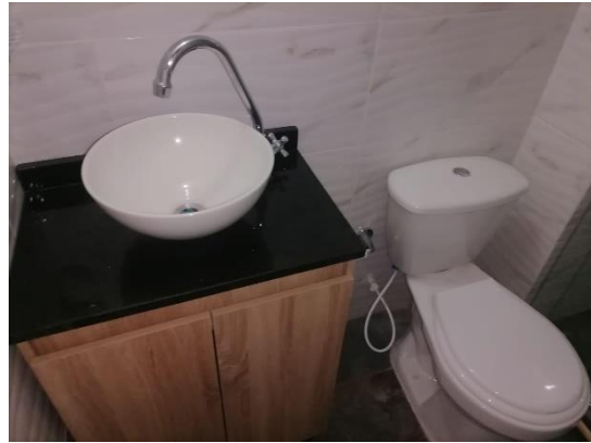
Lavamanos sanitario Apartamento 405
