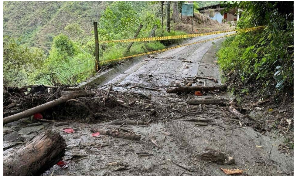
Tras la afectación del puente en Pedregales, la administración municipal solicitó apoyo de los gobiernos departamental y nacional.
