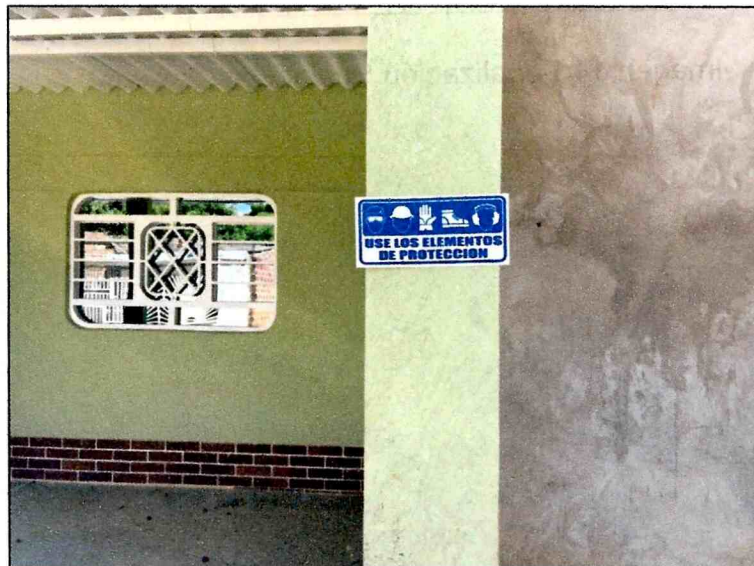
Imagen 13 Señalización Uso de EPP
