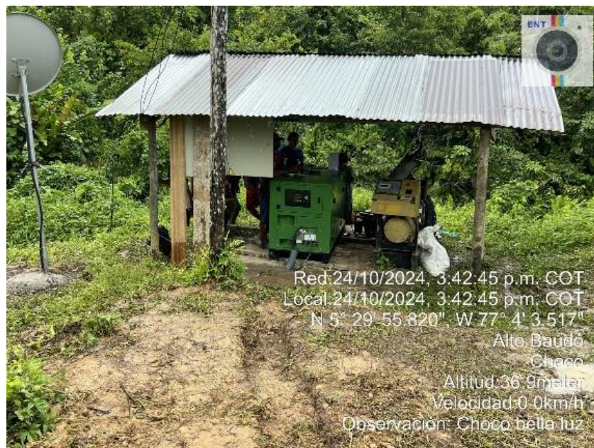
Imagen 2. Instalación física de la central de generación
