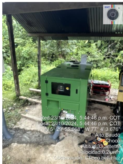
Imagen 3. Central de Generación
