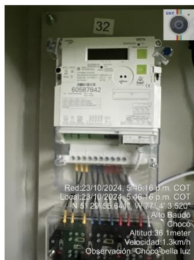
Imagen 7. Medidor Landis + Gyr
