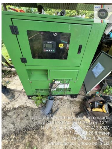
Imagen 4. Salida de potencia del grupo electrógeno
