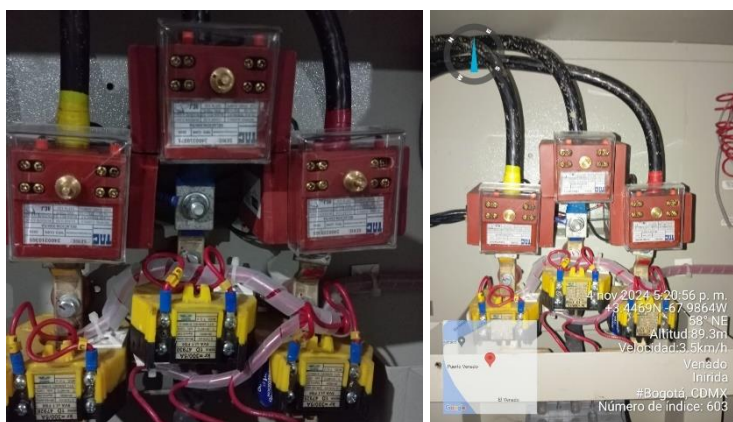
Imagen 8. Placa de características de CT's
