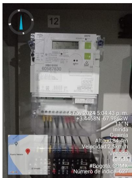
Imagen 7. Medidor Landis + Gyr
