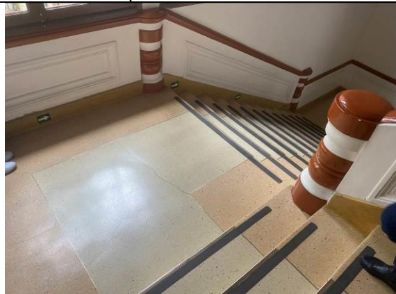
Fotografía 7. Grieta en el descanso de la escalera del costado noroccidental de la edificación central.
