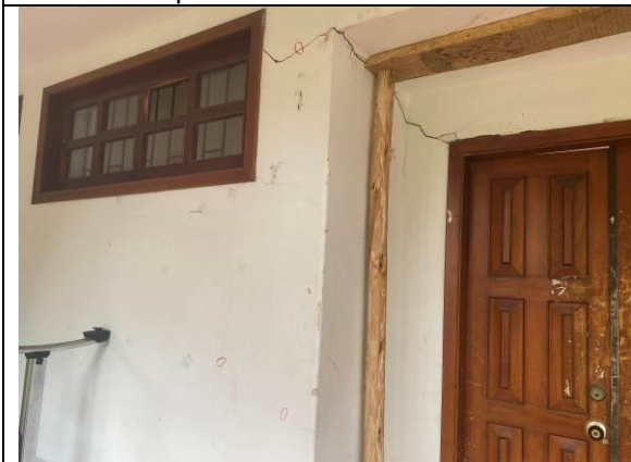
Fotografía 13. Incremento leve en abertura y longitud de las grietas.
