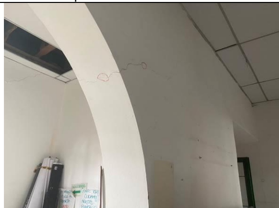
Fotografía 14. Incremento leve en abertura y longitud de las grietas.
