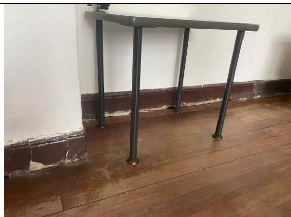
Fotografía 5. Hundimiento en el recubrimiento en madera del piso.
