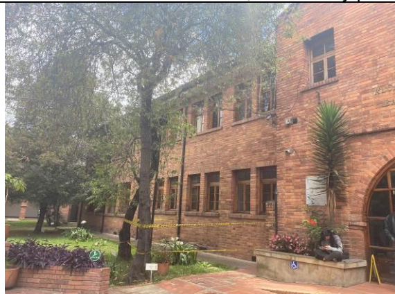
Fotografía 19. Desprendimientos de algunas baldosas de la superficie de los senderos de acceso a las edificaciones.
