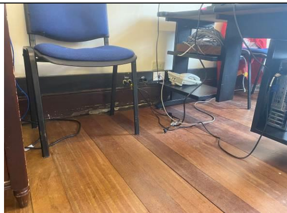
Fotografía 6. Hundimiento en el recubrimiento en madera del piso.
