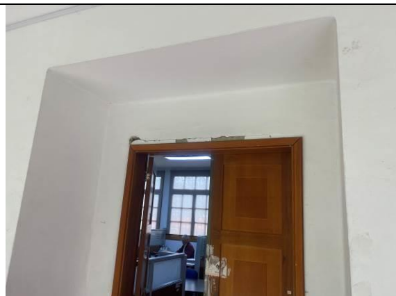
Fotografía 16. Desprendimientos del mortero de pega del marco en madera de la puerta.
