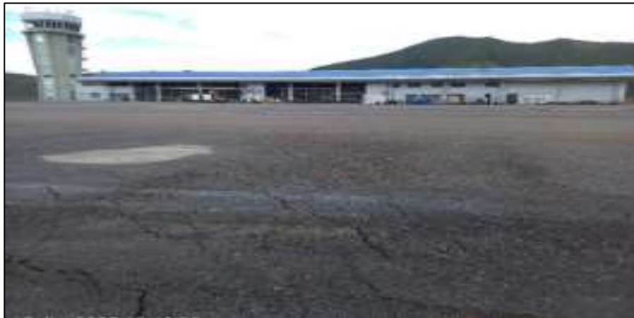
Fotografía No.: 1 Plataforma, pavimento con grietas longitudinales y piel de cocodrilo.
