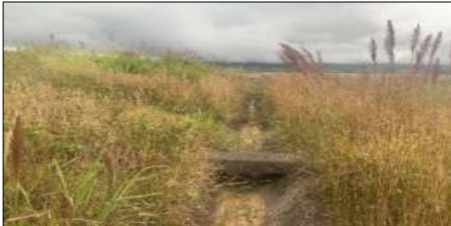
Fotografía No.: 4 Canales y obras de drenaje, se requiere realizar rehabilitación y mantenimiento.
