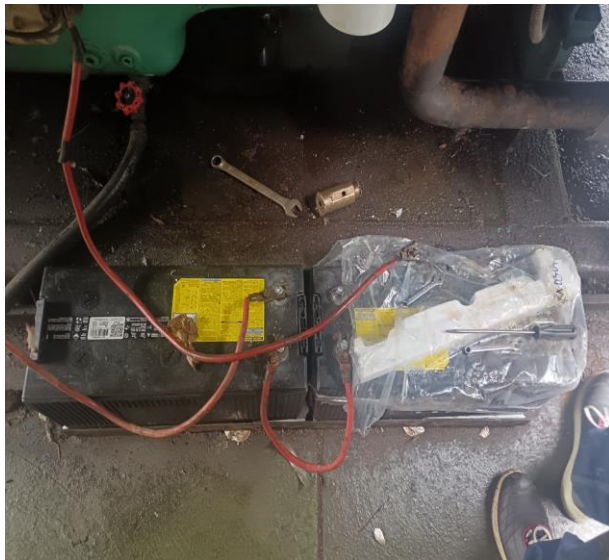
Foto 5. Suministro Baterías 4D
