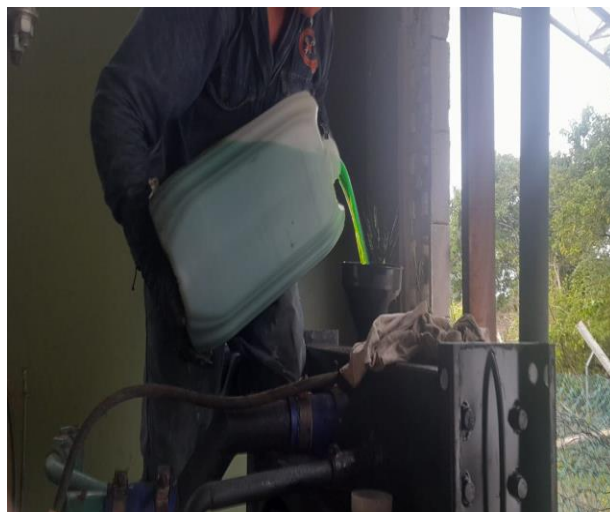
Foto 11. Suministro cuñete de refrigeración
