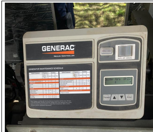
Foto 5. Prueba De Funcionamiento Manual Y Automático
