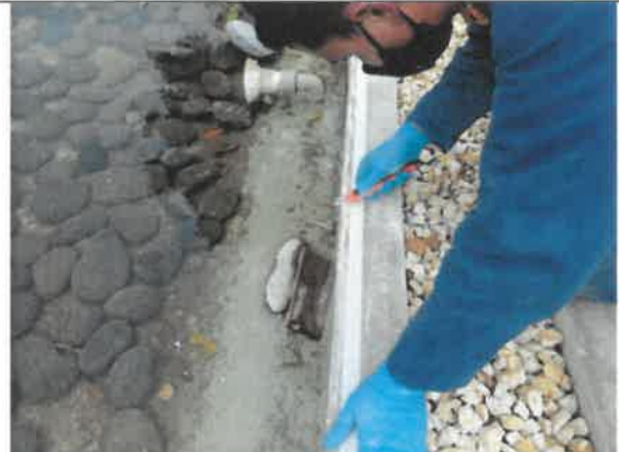
Foto No.118. Se revisa y verifica el arreglo de las fisuras que se presenta en el perímetro de los espejos de agua. En la sede CENTRO DE MEMORIA PAZ Y RECONCILIACION
