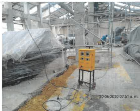
Foto No. 58. Se revisó y verificó equipo tablero eléctrico, en el frente de obra IMPRENTA DISTRITAL
