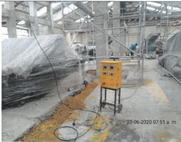
Foto No. 7. TABLERO utilizó este tablero eléctrico para alimentar los diferentes equipos como pulidores, taladros, tronzadora y mezcladora utilizado para los diferentes procesos constructivos del reforzamiento estructural.
