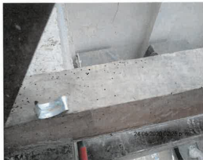
FOTO No 36: La interventoría ARQUITECTURA URBANA LTDA revisa y verifica en conjunto con el contratista de obra CONSORCIO PRUNI SEDES 04 la cercha I3, para diagnosticar que elementos en madera se deben reemplazar por que presentan deterioro por gorgojo.
