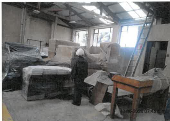
FOTO No 64: La interventoría ARQUITECTURA URBANA LTDA revisa y verifica que el contratista de obra realice la reparación del embalaje de las maquinas ubicadas en el área de producción.
