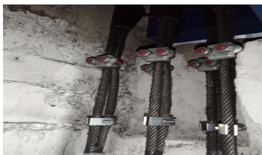
Foto 2. Se evidencia mezcla de diferentes tipos de amarres en cables de tracción
