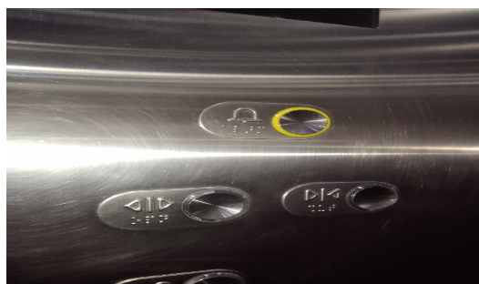
Foto 1. No funciona intercomunicador
