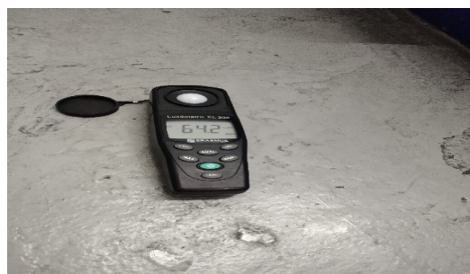
Foto 2. Iluminación en sala de máquinas es inferior a 200 Lux
