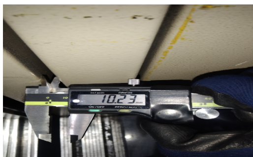
Foto 4. Holguras en puertas de hall superan los 6 mm
