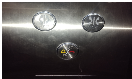
Foto 3. No funciona intercomunicador
