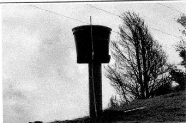
Imagen 5. Pedestal para tanque de almacenamiento de 500 lts.
