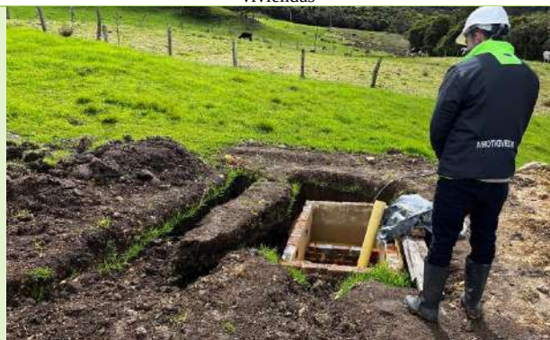
Ilustración 55. Verificación de localización del sistema séptico
