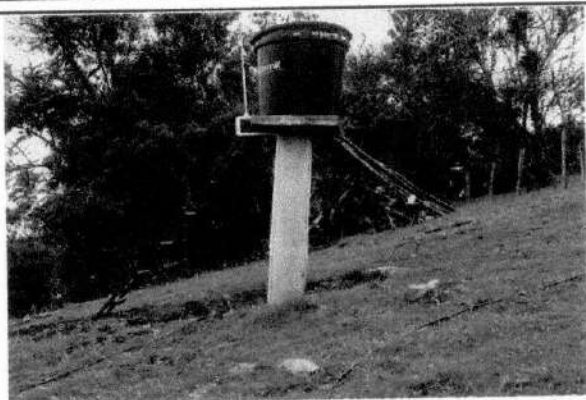
Imagen 5. Pedestal para tanque de almacenamiento de 500 lts.
