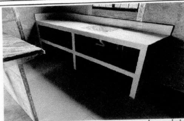
Imagen 4. Meson en concreto con lavaplatos y griferia.
