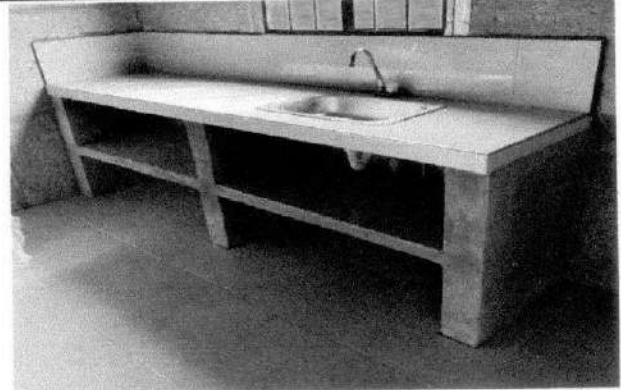
Imagen 4. Meson en concreto con lavaplatos y griferia.
