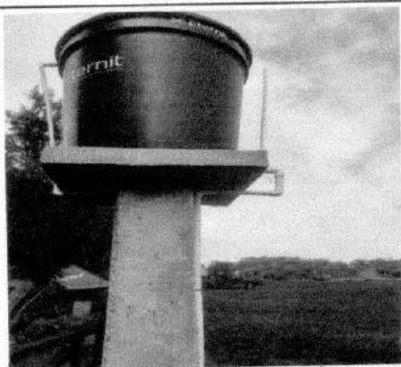
Imagen 5. Pedestal para tanque de almacenamiento de 500 lts.
