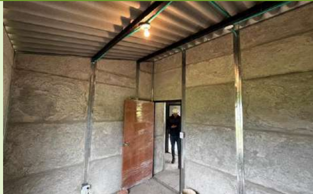
Ilustración 101. Prueba Eléctrica en Alcoba No. 1
