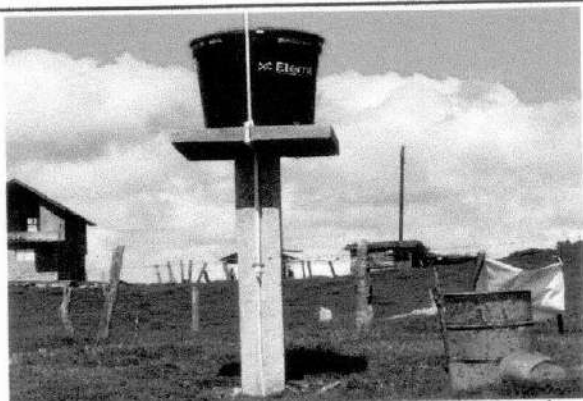
Imagen 5. Pedestal para tanque de almacenamiento de 500 lts.
