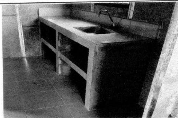
Imagen 4. Meson en concreto con lavaplatos y griferia.
