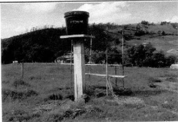
Imagen 5. Pedestal para tanque de almacenamiento de 500 lts.
