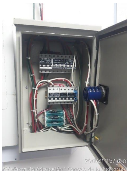
FOTOGRAFIA 20: CABLEADO A GABINETE DE TRANSFERENCIA UPS
