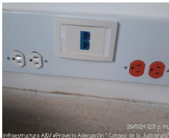
FOTOGRAFIA 17: INSTALACION DEL RACK Y PUNTOS NO REGLADOS
