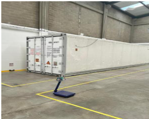
AREA BODEGA: CUARTO FRIO - CONTENEDOR
