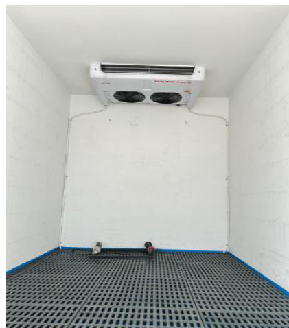
INTERIOR VEHICULO TRANSPORTADOR PLACA NOY-191 - REFRIGERACIÓN O CONGELACIÓN
