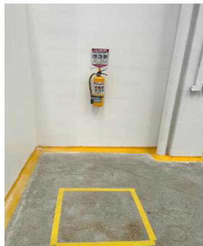
AREA NO CONFORME – ESTACIÓN EXTINTOR
