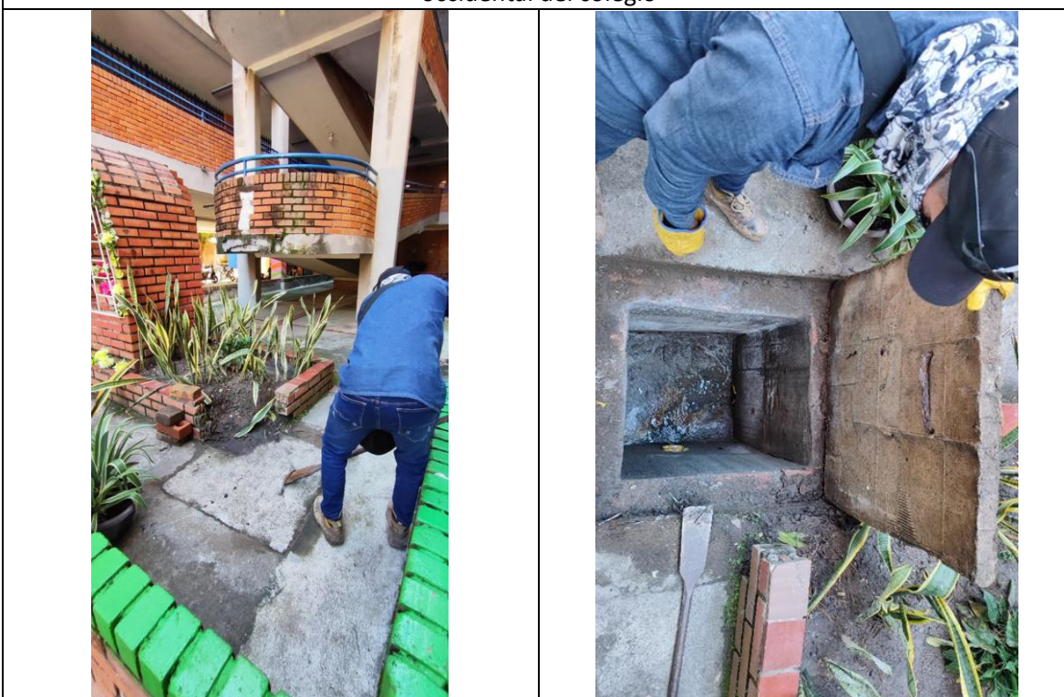
Caja de aguas lluvias al lado de la gruta, provienen aguas de los aires acondicionados y lavatraperos
