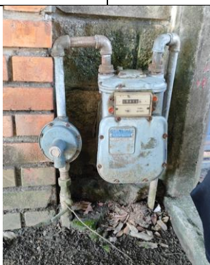
Medidor de gas ubicado fuera de la institución
