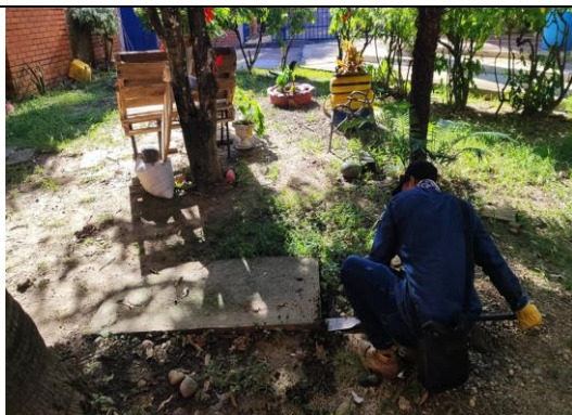
Caja de aguas negras ubicada entrando al colegio a mano derecha pasando la reja, sobre la zona verde. Se encuentra obstruida
