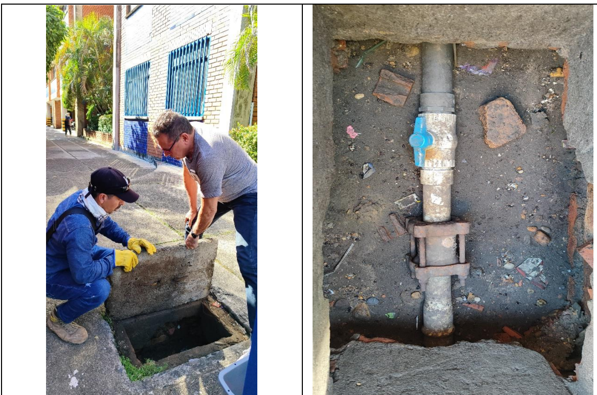
Válvula de 2" ubicada detrás de la portería
