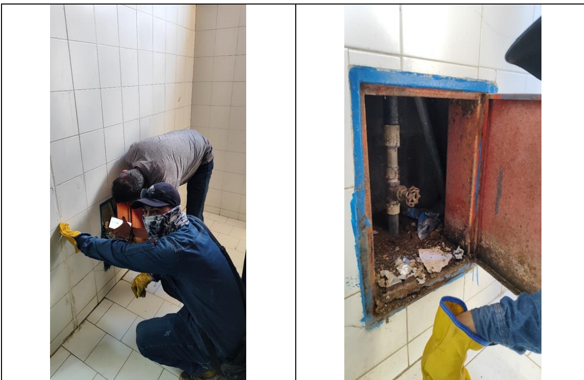
Válvula de tubería que sube a tanque elevado ubicada en los baños de hombres sector occidental del colegio
