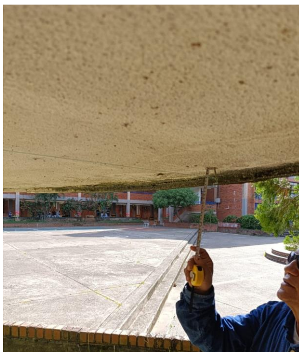
Ilustración 7 Deflexiones en los descansos de las escaleras
