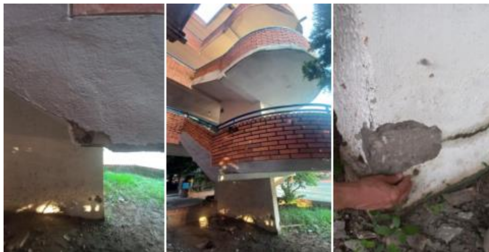
Ilustración 6 Desprendimiento de material en elementos estructurales
