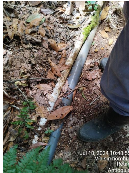
Ilustración 21 Tubería de aducción expuesta susceptible a daños
