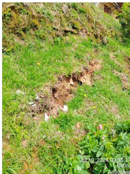
Ilustración 22 Falla en talud en predio donde se ubica la PTAP
