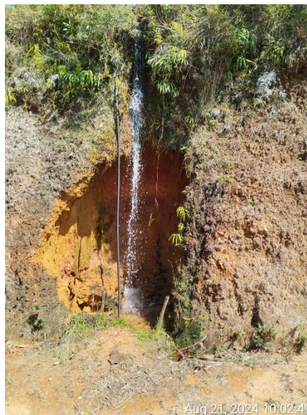
Ilustración 10 Socavación en purgas de lodos
