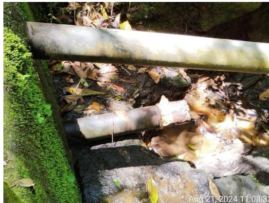
Ilustración 9 Reparaciones poco técnicas
