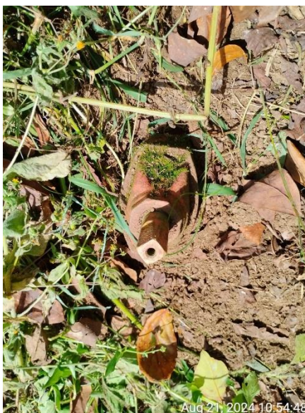
Ilustración 12 Válvula afectada por la intemperie
