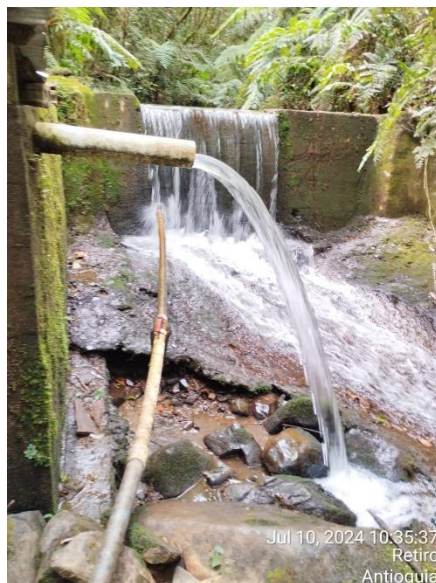
Ilustración 20 Socavación en zona de captación
