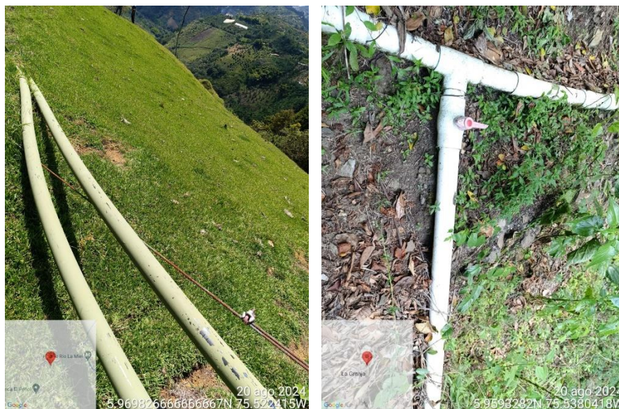
Ilustración 16 Tubería de aducción expuesta susceptible a daños
