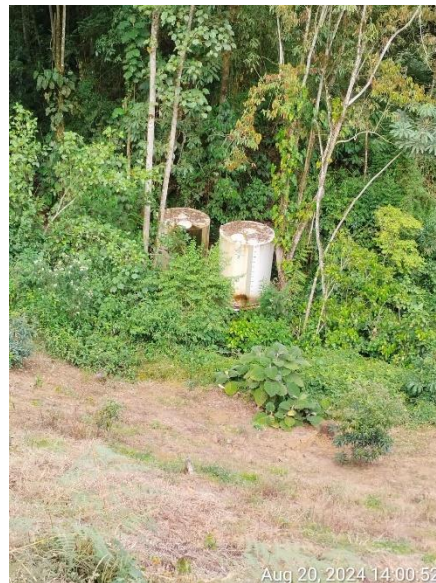
Ilustración 12 Tanques de almacenamiento
