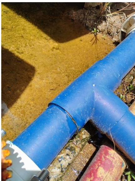
Ilustración 12 Fuga de agua identificadas
