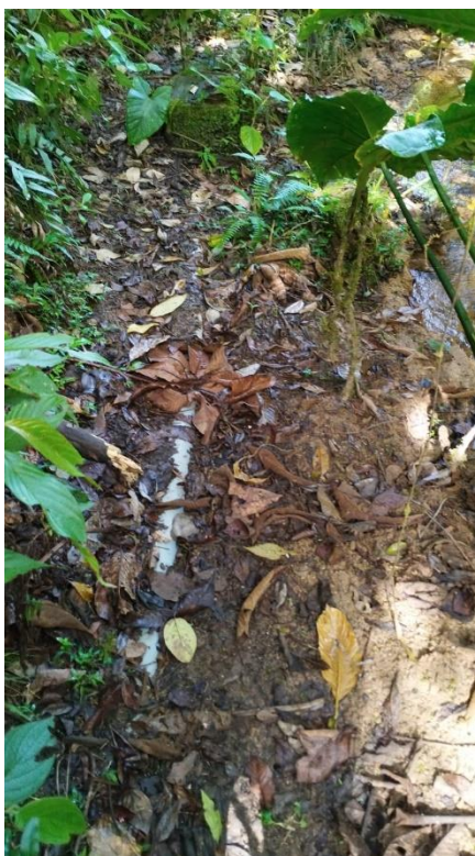
Ilustración 7 Tubería expuesta susceptible a daños
