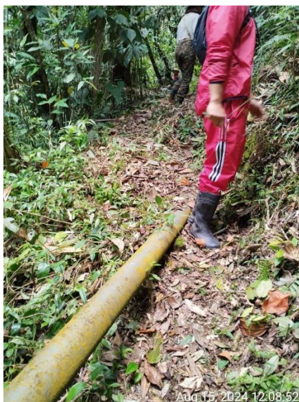
Ilustración 14 Tubería de aducción expuesta
