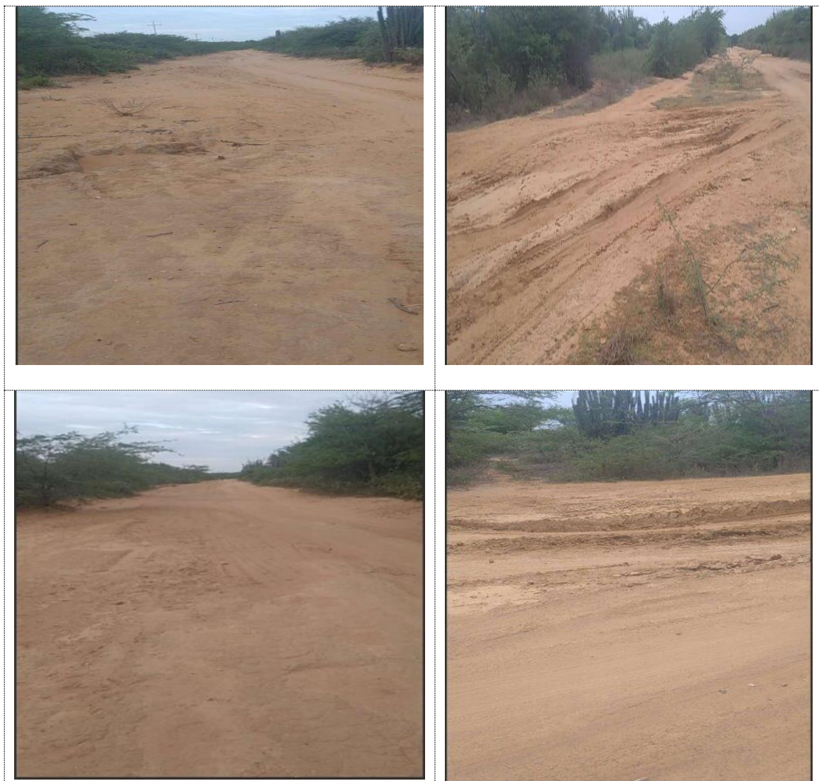
Figura 12. Estado inicial de la vía a Shiruria
