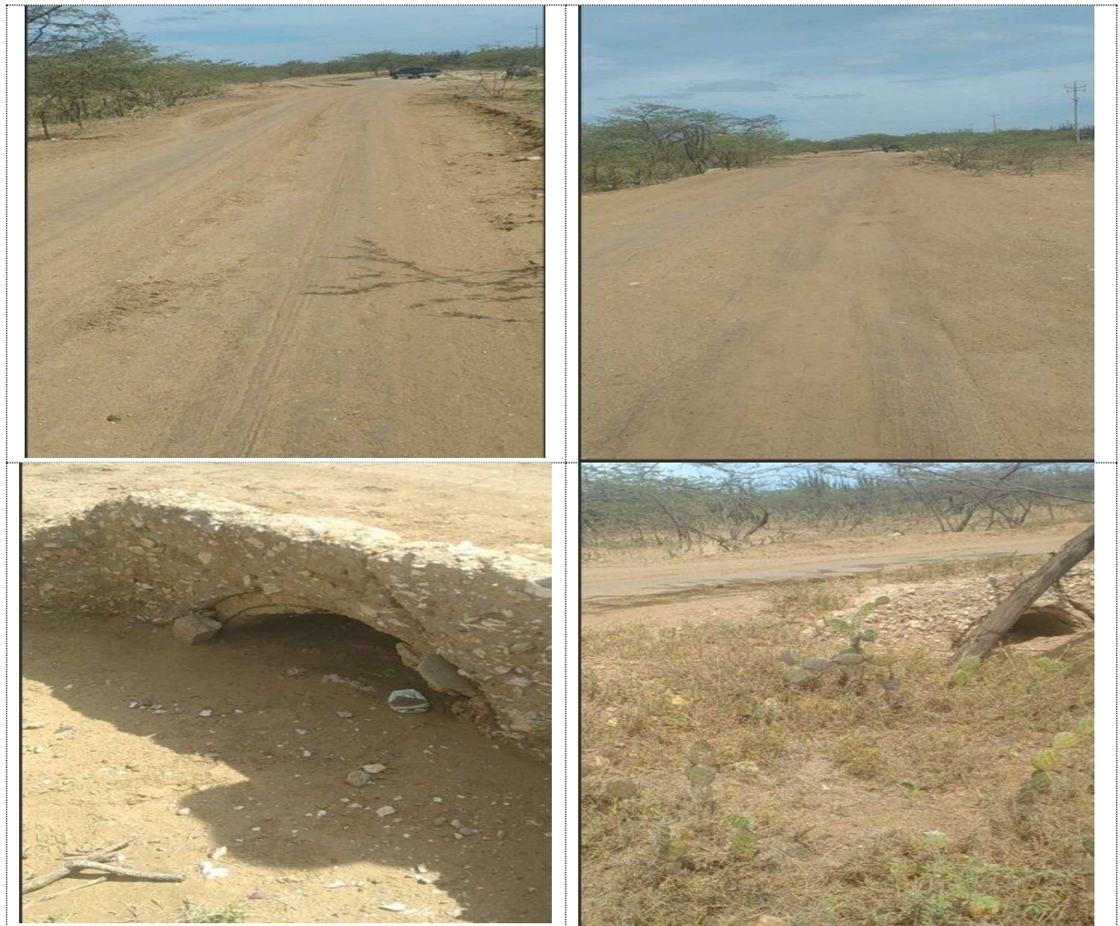
Figura 8. Estado inicial de la vía a Cardón
