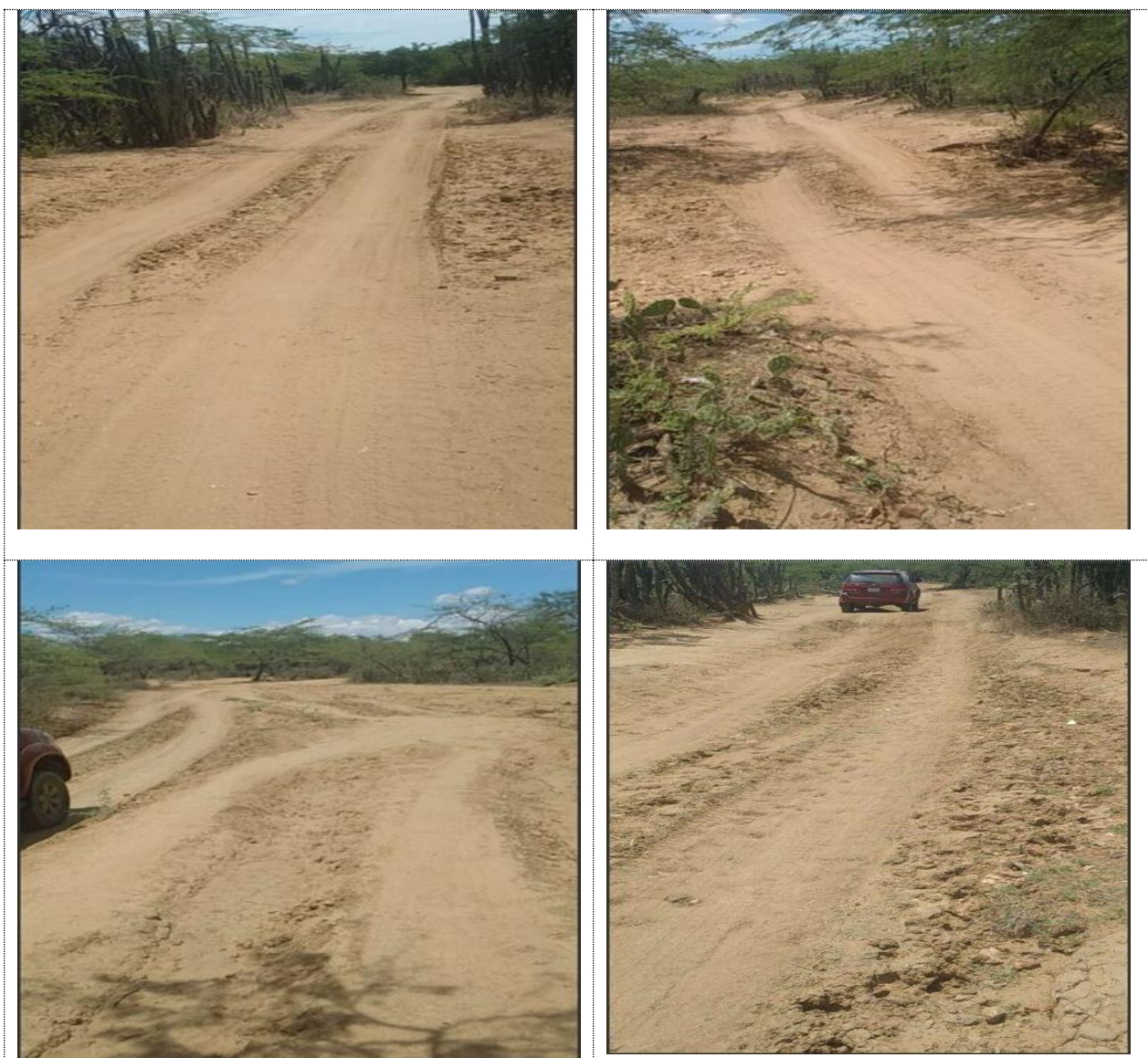
Figura 10. Estado inicial de la vía a Jonjocito
