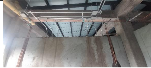
Instalación red gases medicinales
