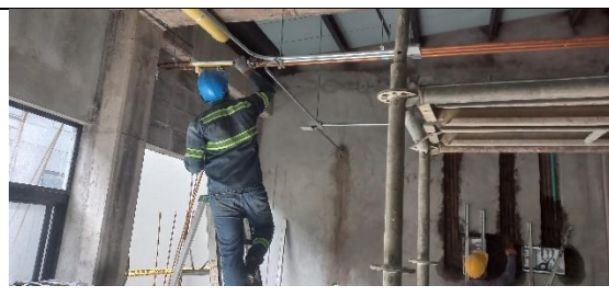
Instalación red gases medicinales
