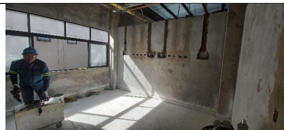
Instalación red gases medicinales
