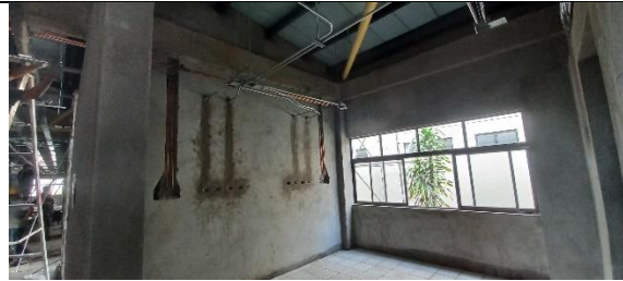
Instalación red gases medicinales
