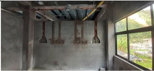
Instalación red gases medicinales
