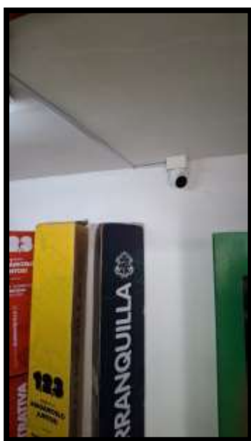
CAMARA PISO 2 – PASILLO
