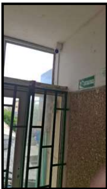
CAMARA PISO 2 – ASCENSOR
