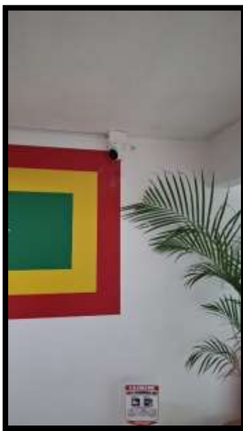
CAMARA PISO 4 – PASILLO
