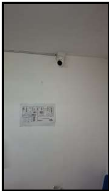
CAMARA PISO 7 - PASILLO
