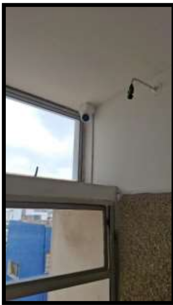
CAMARA PISO 4 – ASCENSOR
