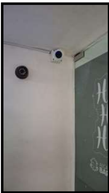
CAMARA PISO 3 – PASILLO
