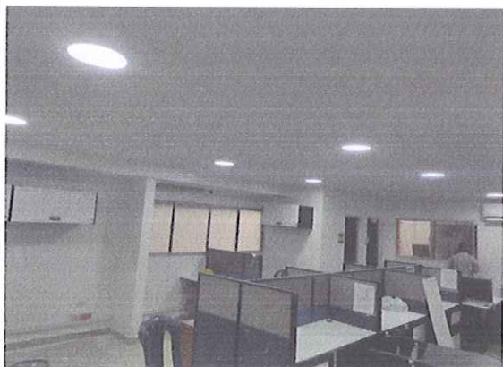
SUMINISTRO E INSTALACIÓN DE LAMPARAS CIRCULARES LED
