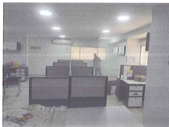
SUMINISTRO E INSTALACIÓN DE LAMPARAS CIRCULARES LED
