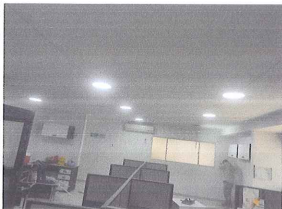
SUMINISTRO E INSTALACIÓN DE LAMPARAS CIRCULARES LED
