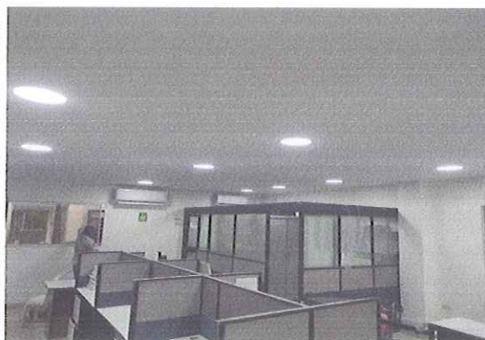
SUMINISTRO E INSTALACIÓN DE LAMPARAS CIRCULARES LED
