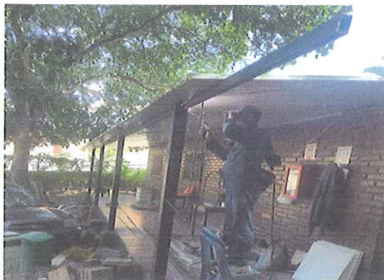
VIGA METALICA FACHADA CAMBIO CLIMATICO (3*1 1/2)
