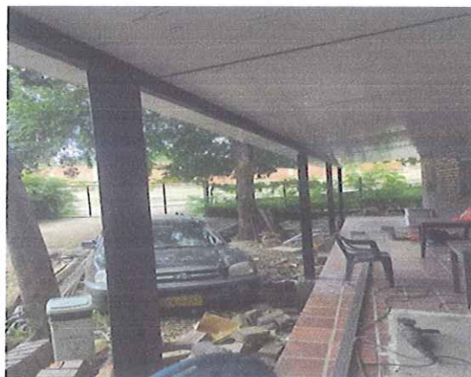
VIGA METALICA FACHADA CAMBIO CLIMATICO (3*1 1/2)
