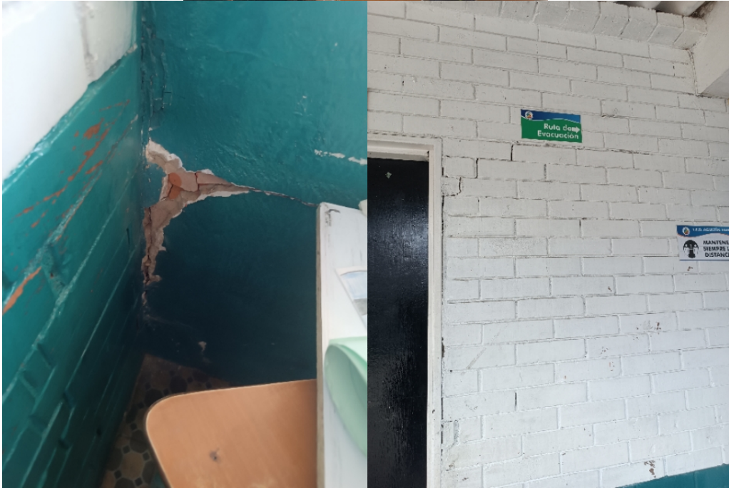
Fotografías 3 a 11. Patologías estructurales en los salones. Fuente propia.
