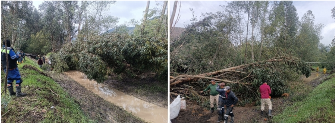
Fotografías 7 y 8. Estado actual del talud marginal izquierdo.
