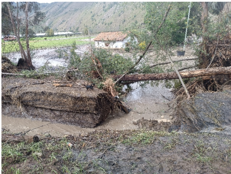
Fotografía 9. Estado actual del talud marginal izquierdo.
