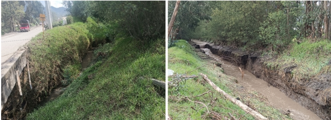
Fotografías 1 y 2. Estado actual de la quebrada Pueblo Viejo aguas arriba del puente vehicular.
