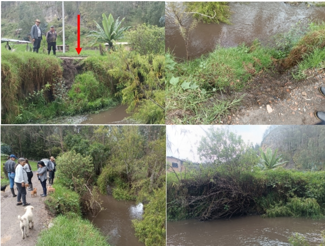
Fotografías 1, 2, 3 y 4. Estado del talud marginal derecho. Fuente: Propia
