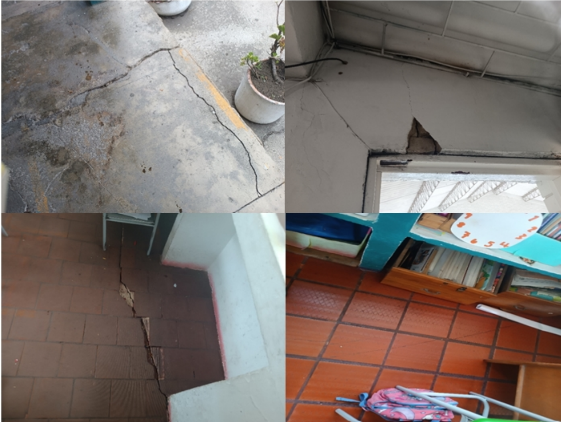
Fotografías 12 a 15. Humedad, hundimiento y levantamiento de pisos. Fuente propia.
