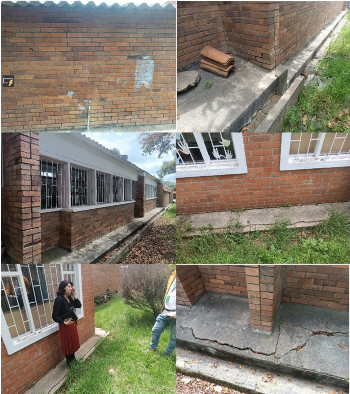
Fotografías 16 a 21. Patologías en muros exteriores, andenes y senderos. Fuente propia.
