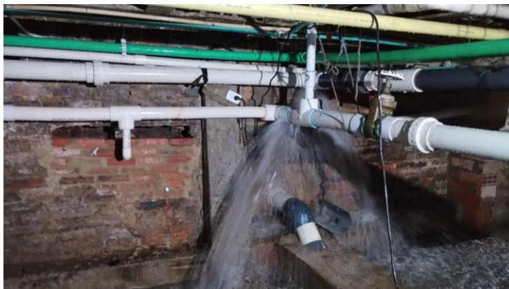
Ilustración 2 deterioro de tubería cuarto de maquinas
