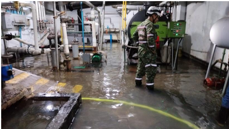
Ilustración 4 inundación de cuarto de maquinas
