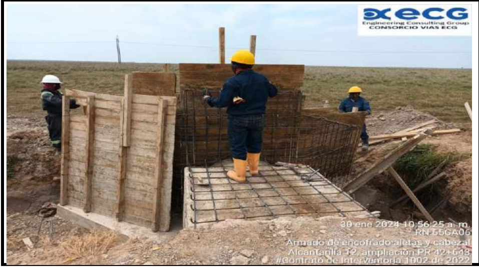
Mejoramiento con material seleccionado
