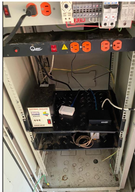
Imagen No 8 Rack de Comunicaciones
