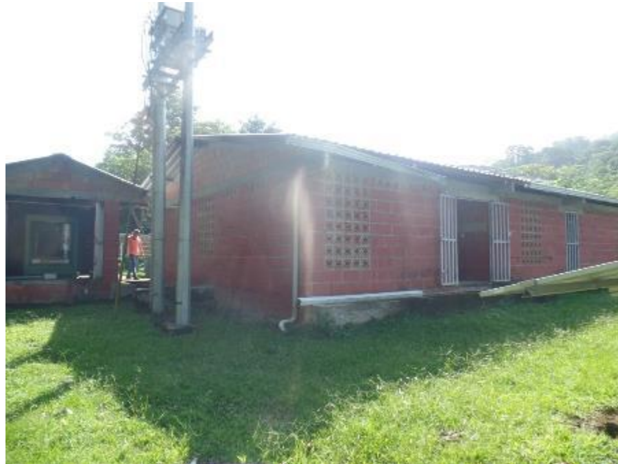
Imagen No 2 instalación física planta de generación
