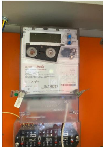
Imagen No 7 Gabinete de Medidor
