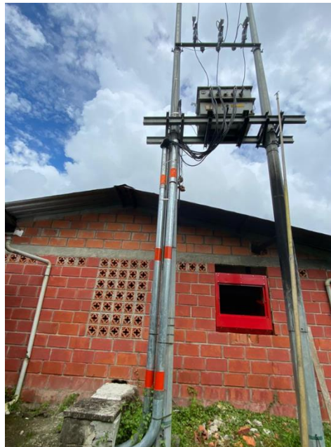
Imagen No 5 Transformador de potencia
