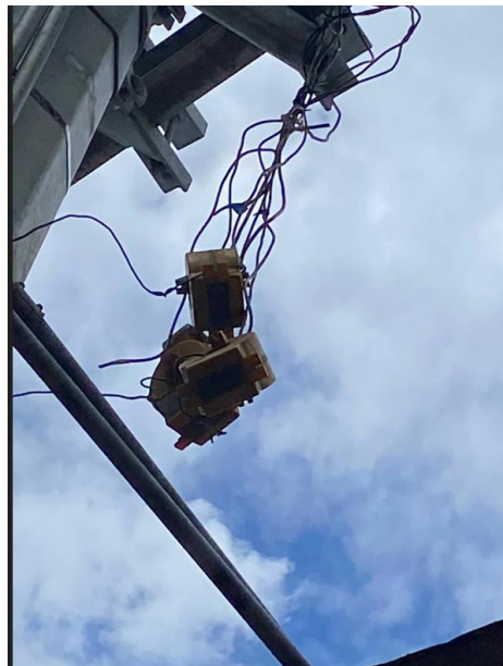
Imagen No 6 Transformadores de medida
