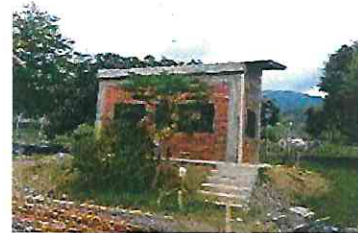
FOTOGRAFÍA No. 32: Caseta eléctrica
