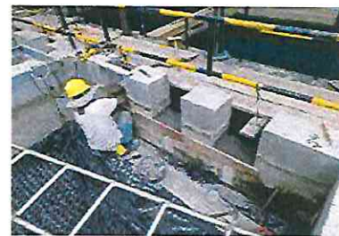
FOTOGRAFÍA No. 36: Se toman niveles en las ventanas donde se apoyaran las cerchas y también se deben corregir. Se hace demolición y se resana de nuevo
