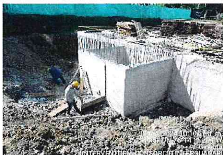
FOTOGRAFÍA No.7: Caja de entrada a el tanque de almacenamiento
