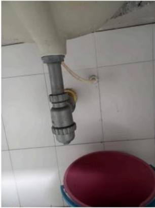
IMAGEN 2: Lavamanos con fuga de agua baño hombres
