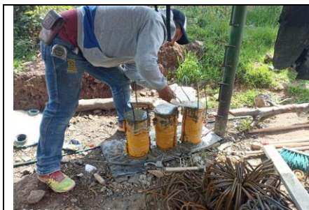
Imagen 47: Toma cilindros concretos ciclópeos
