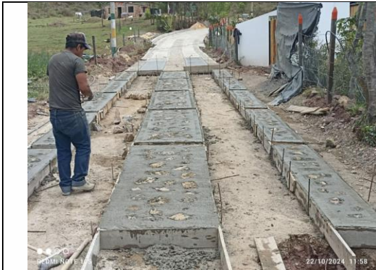
Imagen 01: Conformación de módulos laterales e internos de concreto ciclópeo a la altura de la abscisa k0+099
