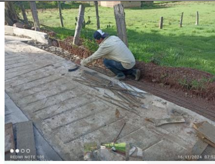
Imagen 14: Instalación de acero de para bordillo a la altura de la abscisa k0+054
