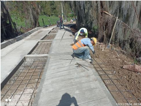
Imagen 11: Instalación de acero de módulos de Cuneta a la altura de la abscisa k0+084
