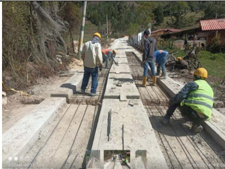
Imagen 09: Instalación de acero de módulos de Placa Huella a la altura de la abscisa k0+078
