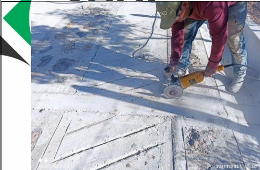
Imagen 42: Corte de dilataciones.
