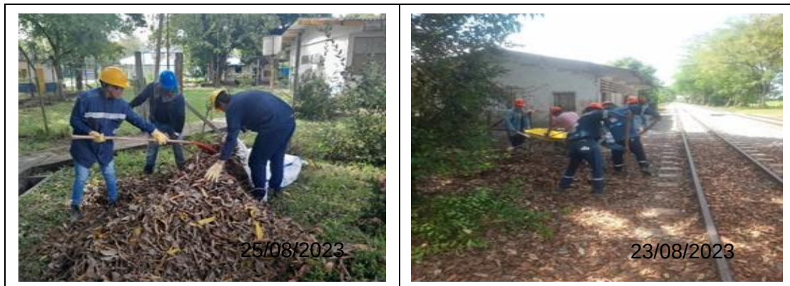
Ilustración 3: Izquierda, Aseo General PK202+200; Derecha, Aseo General PK283+110
