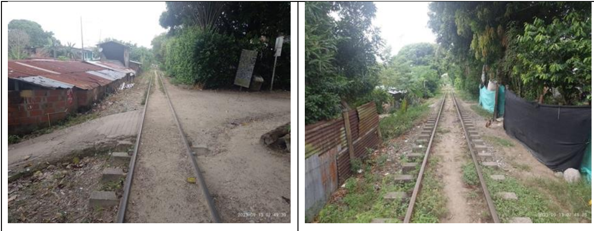
Ilustración 3: Izquierda, Construcciones invadiendo la franja de seguridad pérdida del material de balasto, afectación a la geometría del talud.; Derecha, Pérdida total del material de balasto, traviesas a la vista, vía colmatada.
