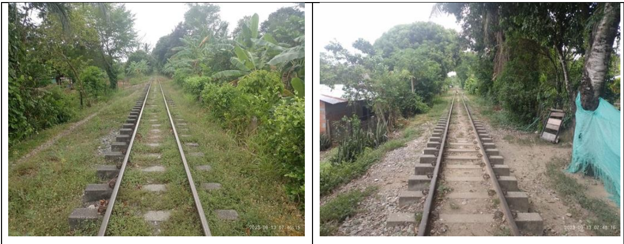
Ilustración 2: Izquierda, Vía colmatada, presenta pérdida total de balasto; Derecha, Erosión presentada en la corona del terraplén.
