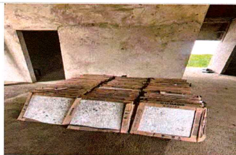
DESCRIPCIÓN: ENCHAPE DE TABLETAS DAÑADAS
