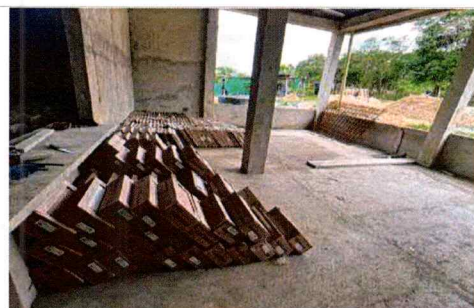
DESCRIPCIÓN: ENCHAPE DE TABLETAS DAÑADAS
