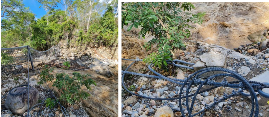
Fotografía 4 y 5. A la derecha se puede ver la barrera dinámica otra vez con material retenido, a la izquierda afectación en dados de concreto.
