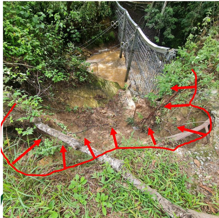
Fotografía 21. Proceso de erosión antes de la zona de la barrera dinámica
