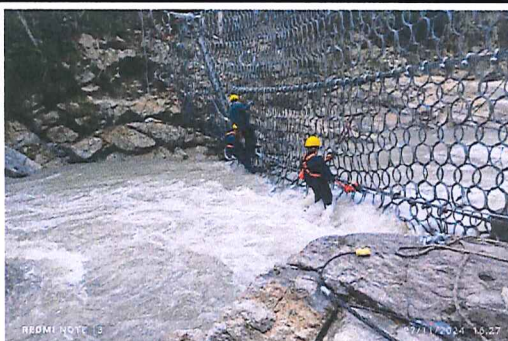
INSTALACIÓN DE FRENOS EN BARRERA K-18
