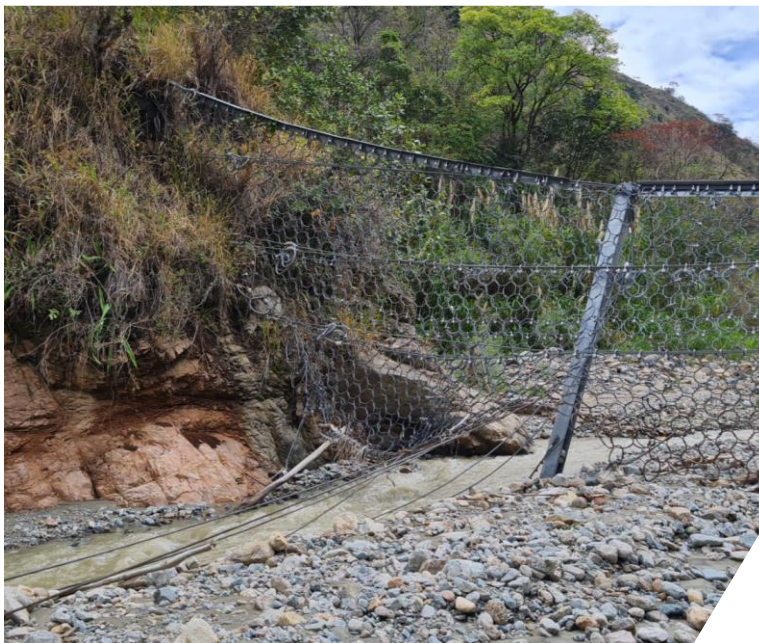
Fotografía 1. Costado derecho de la barrera en donde se ve la afectación de los frenos
