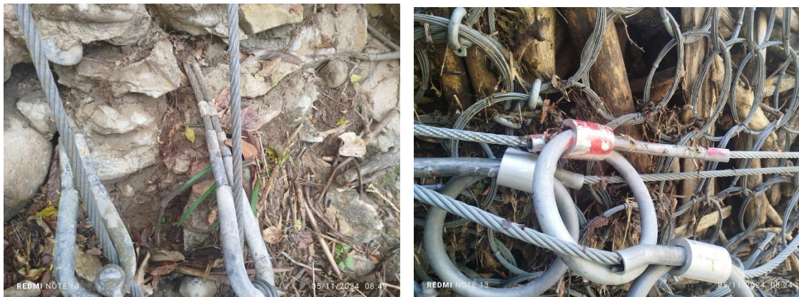
Fotografía 12 y 13. En la fotografía de la izquierda se ven anclajes afectados, en la fotografía de la derecha se ven nuevos frenos activados, incluidos frenos que ya se habían reemplazado
