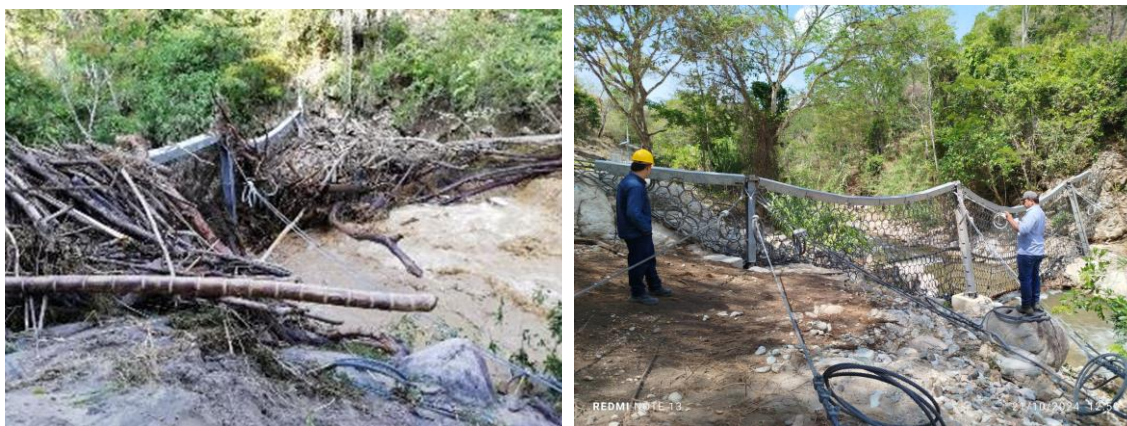
Fotografía 2 y 3. A la izquierda fotografía inicial, a la derecha fotografía del 21 de octubre con barrera limpia y sin malla secundaria
