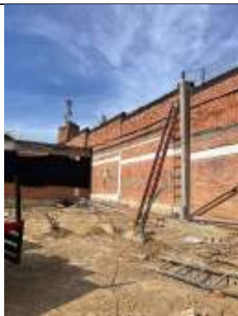
Ilustración 3: 20/12/2024 Metros lineales faltantes de instalación de concertina, ubicación de garita 3
