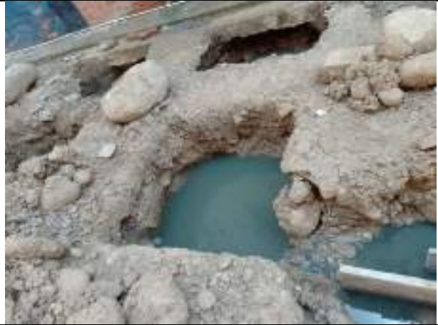
Ilustración 6: 13/01/2025 Persiste la emanación de aguas negras y agua potable
