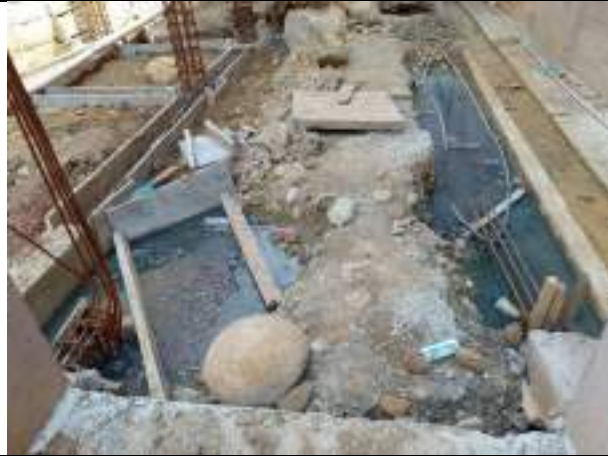
Ilustración 5: 13/01/2025 Persiste la emanación de aguas negras y agua potable
