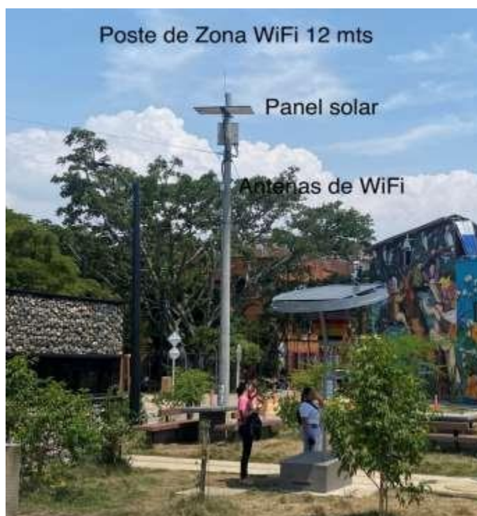
Imagen 5. Ejemplo de Zona WIFI instalada en Bulevar de Oriente
