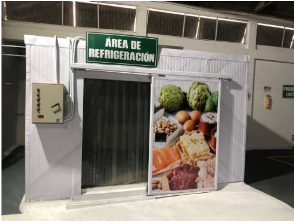
Cuarto Frio de Refrigeración
