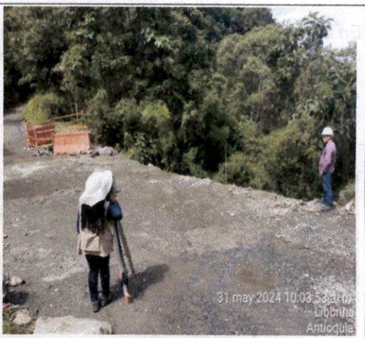
Foto 16 La comisión de topografía realiza levantamiento de la pérdida de banca y socavación muro de contención en la batea abscisa K1+276 margen izquierda.
