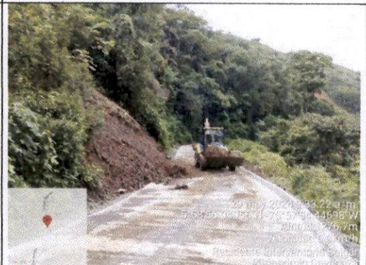
Foto 36 Tramo vial SALGAR: Salgar - La Cámara - La Quiebra (60AN05-1) – Retiro de material sobre la vía por remoción en masa del talud en el K2+000, a razón del periodo de lluvias actual.
