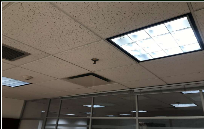
CIELO RASO - SISTEMA DE VENTILACIÓN Y EMERGENCIA
