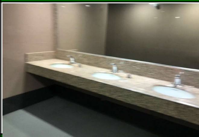
ÁREAS COMUNES BATERIA DE BANOS
