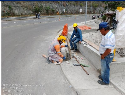
Fotografía 4-21 PK42+440 resanes en bordillos y cunetas. C.D.
