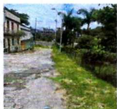
1. REHABILITACIÓN DE LA VÍA QUE ACTUALMENTE SE ENCUENTRA EN MAL ESTADO - CARRERA 68
