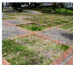
2. RETIRO Y CAMBIO DE ADOQUINES QUE SE ENCUENTRAN EN MAL ESTADO.
