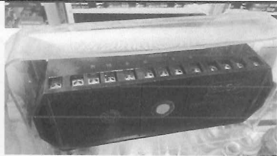
Borneras para medición y control de tensión.
