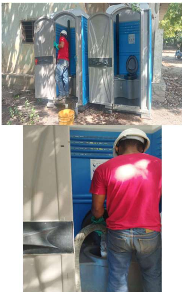
Figura 13: Baterías sanitarias en el frente de trabajo
