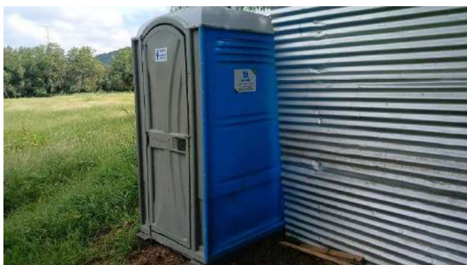
Figura 12: Baterías sanitarias en el frente de trabajo
