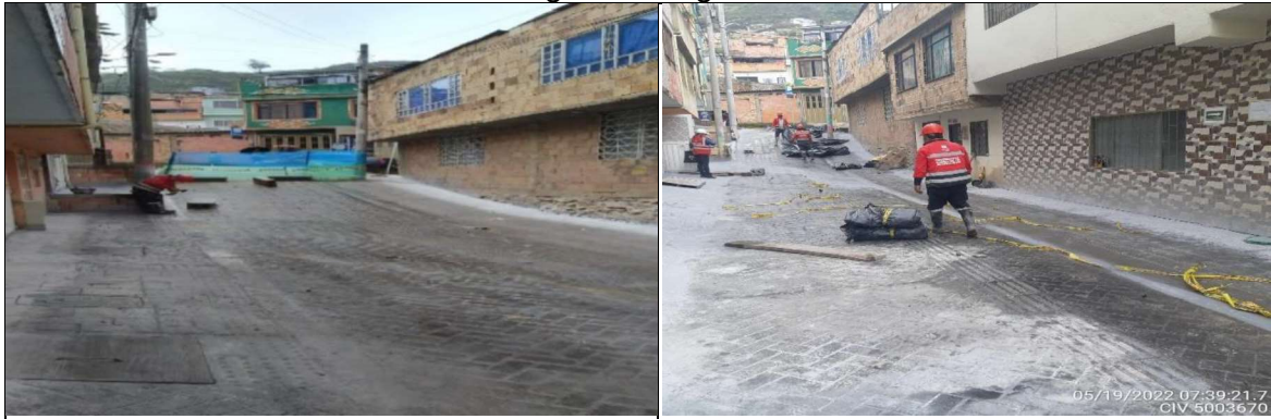
Vista general instalación MR-41
