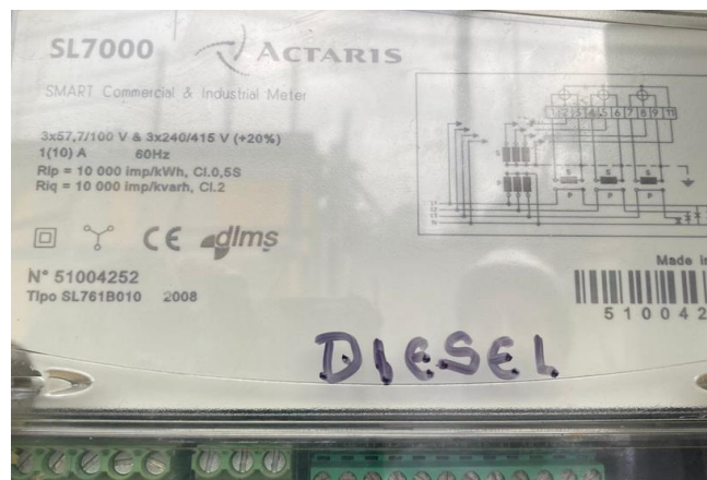
Imagen # 2 Medidor circuito Diesel
