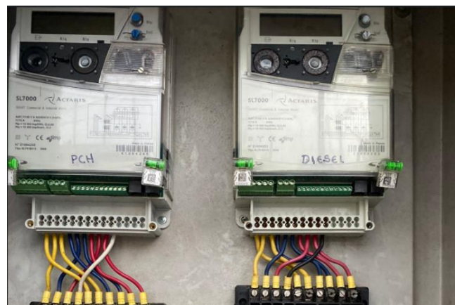
Cuadro No 1 Medidor de energía
