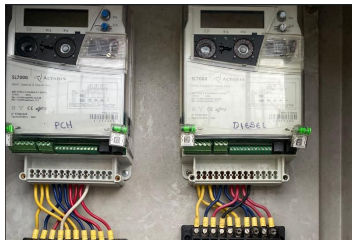
Cuadro No 1 Medidor de energía
