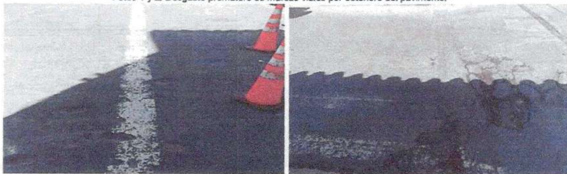
Fotos 1 y 2. Desgaste prematuro de marcas viales por deterioro del pavimento.
