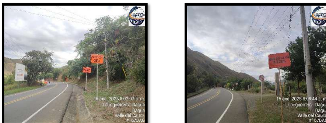
Imagen 7. Señalización instalada en el PR53+950
