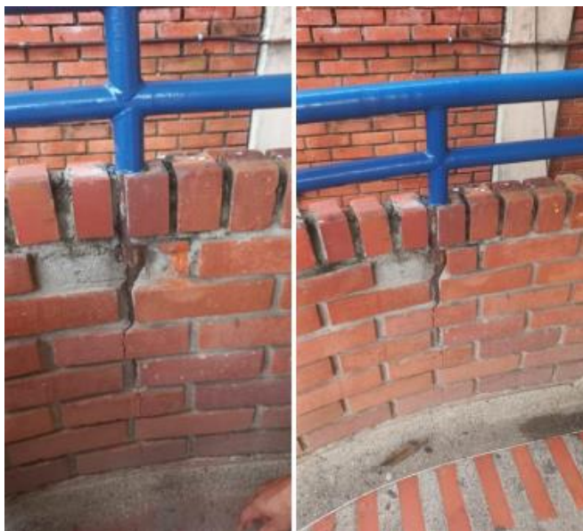
Ilustración 4 Grietas en antepechos de las escaleras
