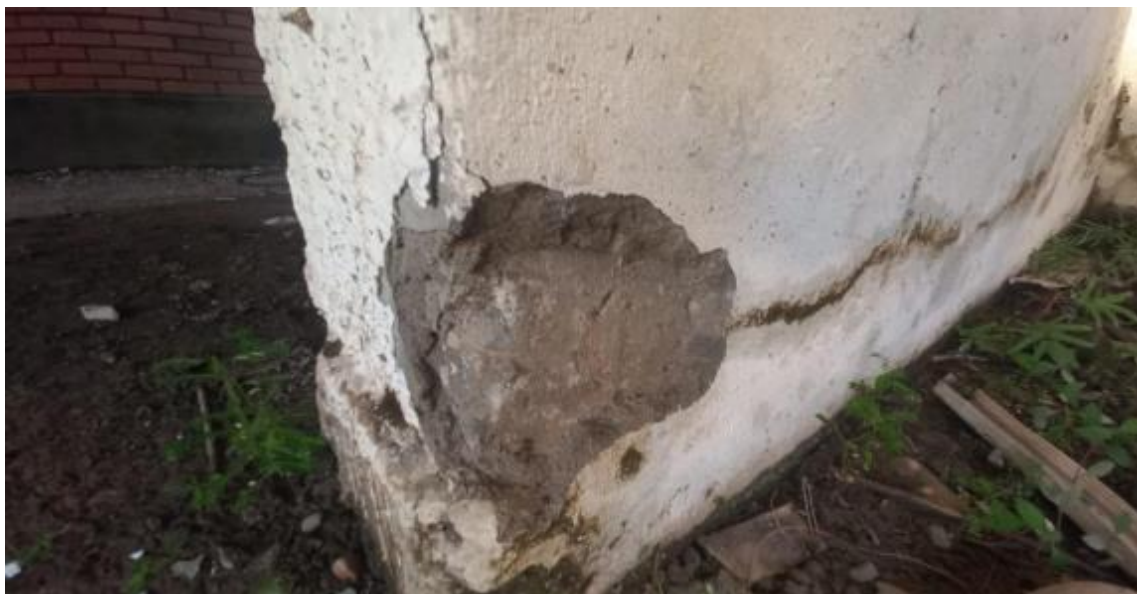
Ilustración 5 Agrietamiento y humedad en elementos estructurales
