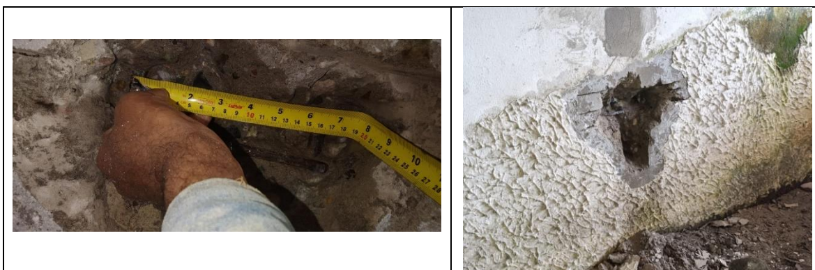
Figura 5 Regata en muro y escalera 1
