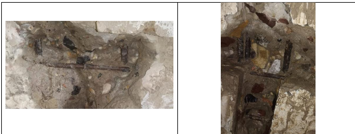
Figura 6 Regata en muro y escalera 2
