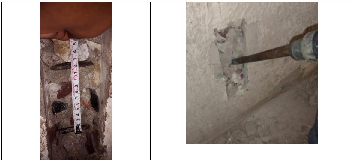
Figura 7 Regata en muro y escalera 3
