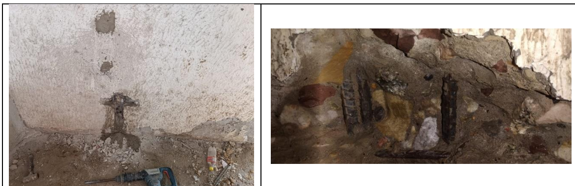
Figura 8 Regata en muro y escalera 4
